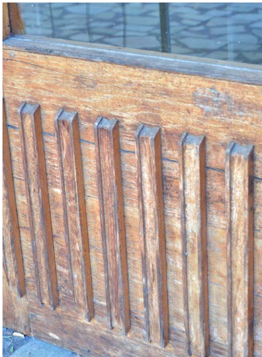
Bild 55. Ekdörrarna utgör en genomtänkt del av byggnadens arkitektur. Att fernissan har flagnat och träet bitvis grånat gör inte att dörrarnas utmärkta kvalitet har försämrats. SLM D2022-0402.
