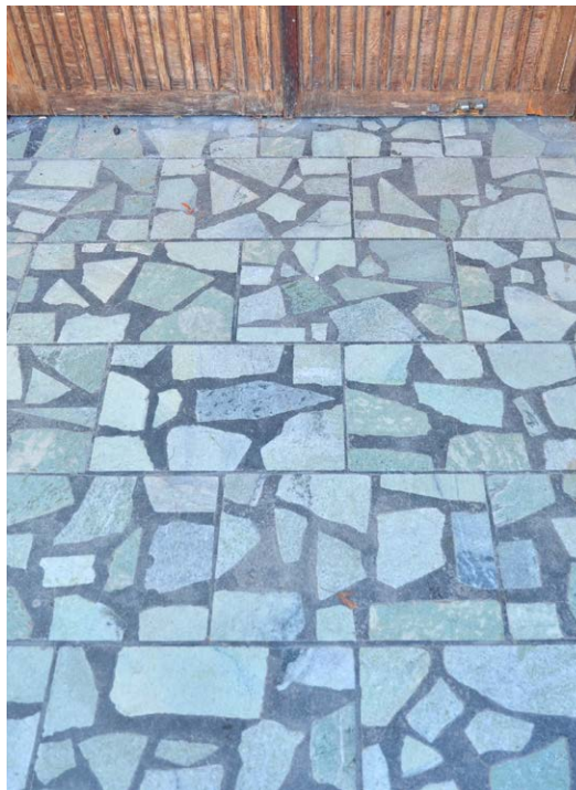
Bild 56. Kolonnadens terazzoliknande golv av marmorskärvor och svartpigmenterat fogbruk är precis som dörrarna omistligt för byggnadens karaktär och kulturhistoriska värden. SLM D2022-0403.
